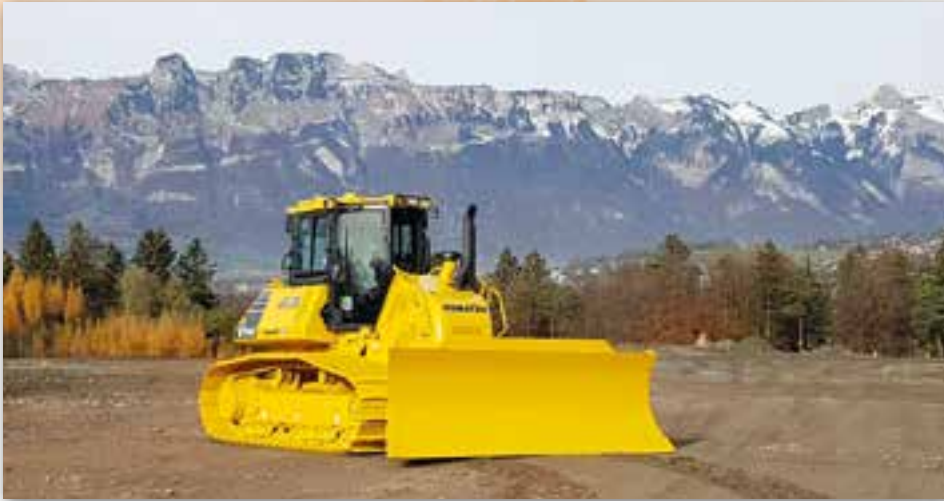
Die Komatsu Planierraupe D61PXi arbeitet besonders effektiv und ist für den Einsatz in der Deponiebewirtschaftung bestens geeignet
